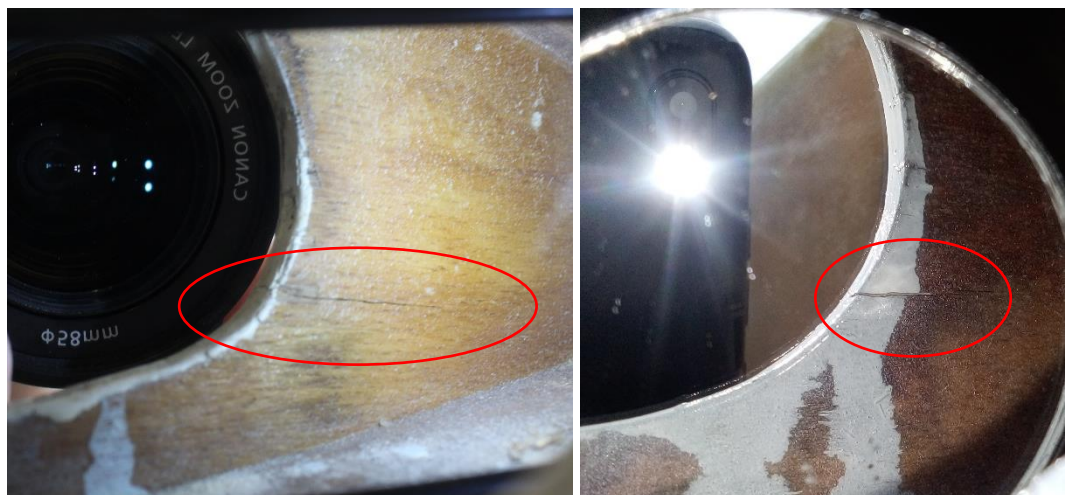
Fig. 4: Risse in der Schubwand
