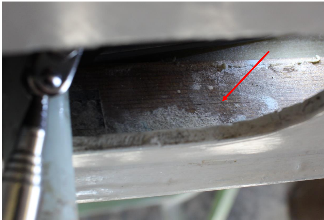
Fig. 3: Risse parallel zur Wurzelrippenebene
