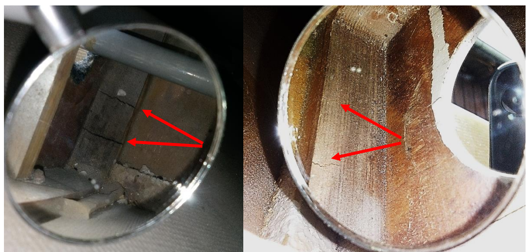
Fig. 1: Risse quer zur Wurzelrippenebene. Links deutlich ausgeprägt, rechts beginnende Anrisse
