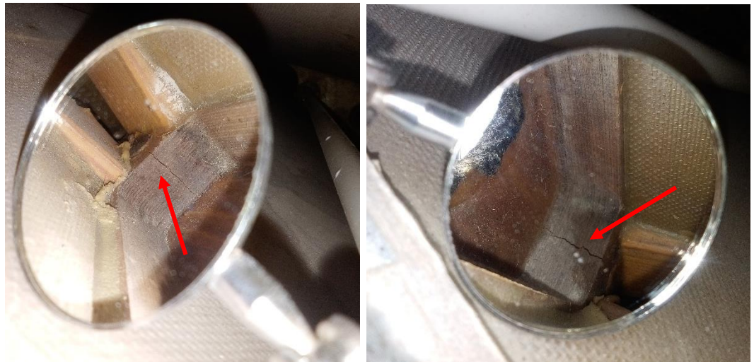
Fig. 2: Risse durch die Aufnahmen der Querkraftbuchsen
